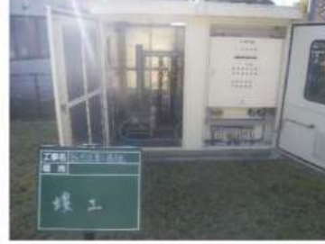
機械室(ユニット)
